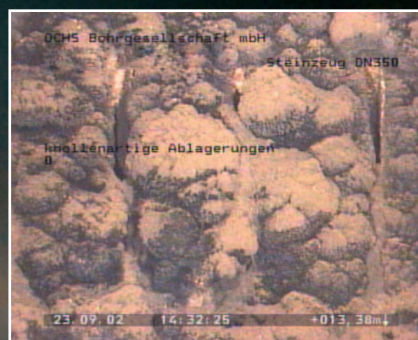
Oben: Bereits verfestigte Verockerung mit Eisenhydroxiden
