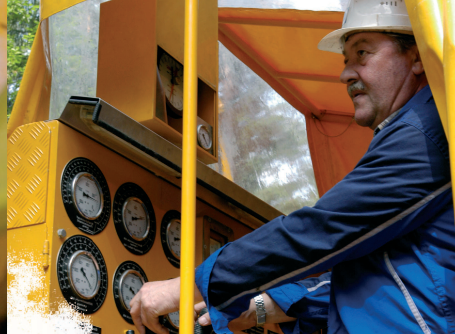
Messinstrumente der Bohranlage
