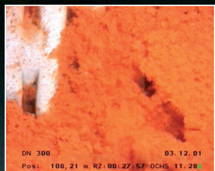
Lockere, watteartige Verockerung mit Eisenhydroxiden
